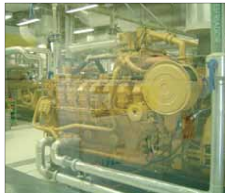
Figura 22: Motores Ciclo Otto importados, em operação em aterro sanitário em São Paulo. Fonte: CENBIO, 2007a.
