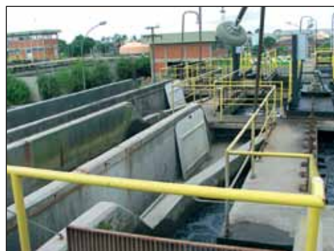
Figura 5: Desarenador após gradeamento Fonte: Instituto AGIR
