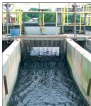
Figura 3: Gradeamento em ETE Fonte: Instituto AGIR
